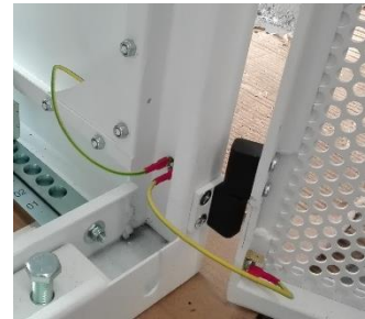
Faston de puesta a tierra en puertas y paneles laterales
